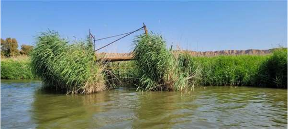
Foto 17: instalación de estructuras destinadas a embarcaderos / puestos de tiro ilegales en el humedal de Castrejón.
