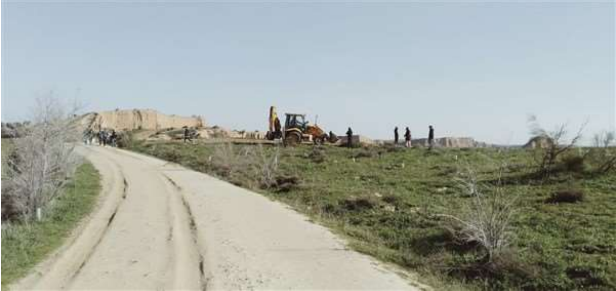
Foto 19: movimiento ilegal de tierras no autorizado en las Barrancas de Castrejón para el rodaje de una serie de televisión.
